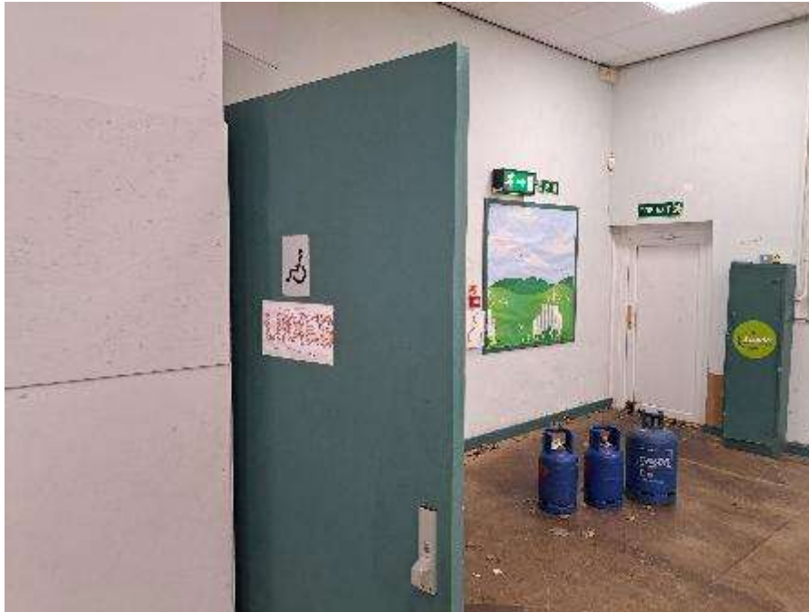
31. Disabled WC door
